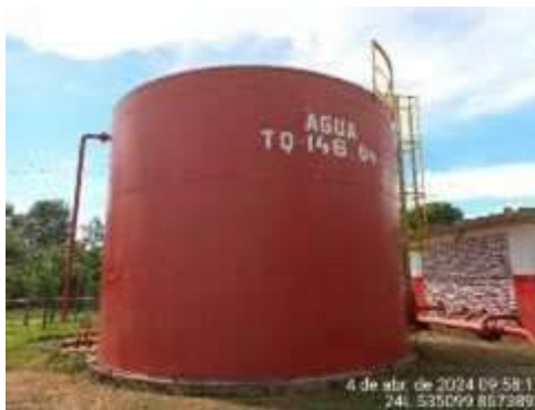
Imagem 11: Tanque de Armazenamento de água (TQ-3146-01-04)
